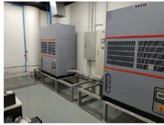
恆溫恆濕空調主機
