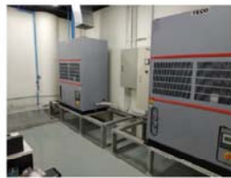
恆溫恆濕空調主機
