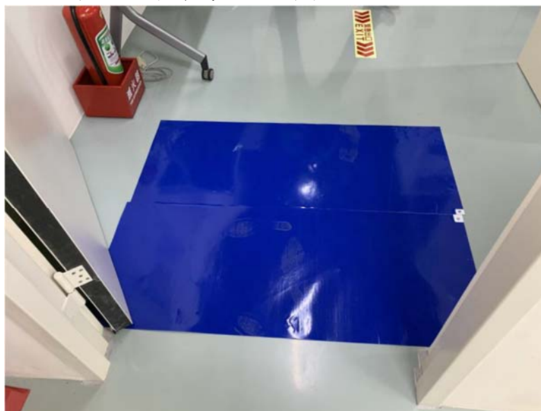
永久檔案庫房入口處設有黏塵板，防止灰塵隨人員夾帶進入
